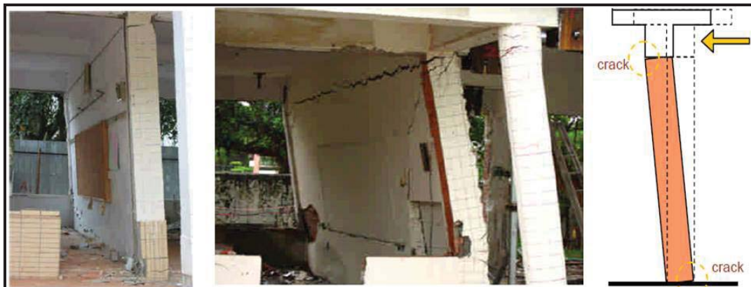
شکل ۱-۲- ایجاد مفصل پلاستیک ترد و بروز ترک‌های افقی در بالا و پایین دیوار به دلیل اتصال گیردار دیوار به دیافراگم‌های کف [۶]
